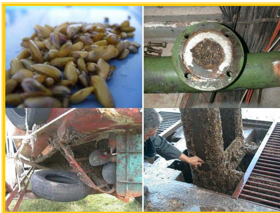
Figura 1. Limnoperna fortunei e infraestructuras afectadas (sistemas de refrigeración, embarcaciones, estructuras de contención).
